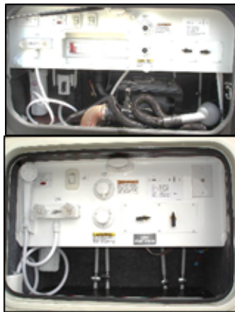
Fig.B - Utility Center
