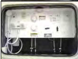
Fig.B - Utility Center
